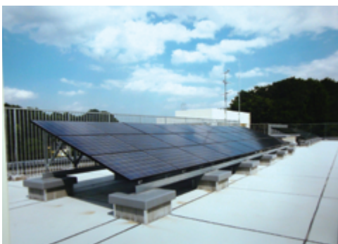
太陽光発電システム
