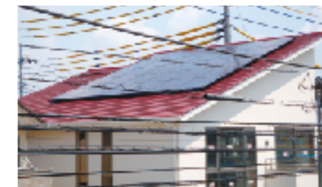
太陽光発電システム
