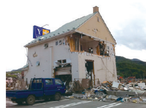
1階は津波による開口部破損、2階はヨットが接触したそうです。
